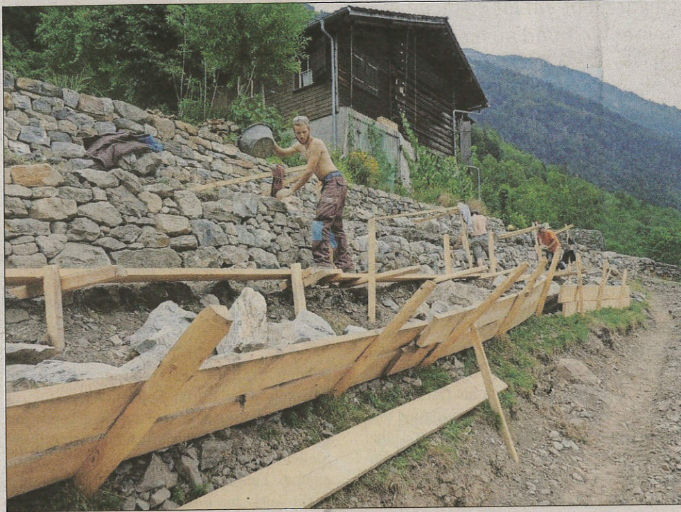
In der Hitze der letzten Tage war die Arbeit an den Trockenmauern sehr schweisstreibend.
